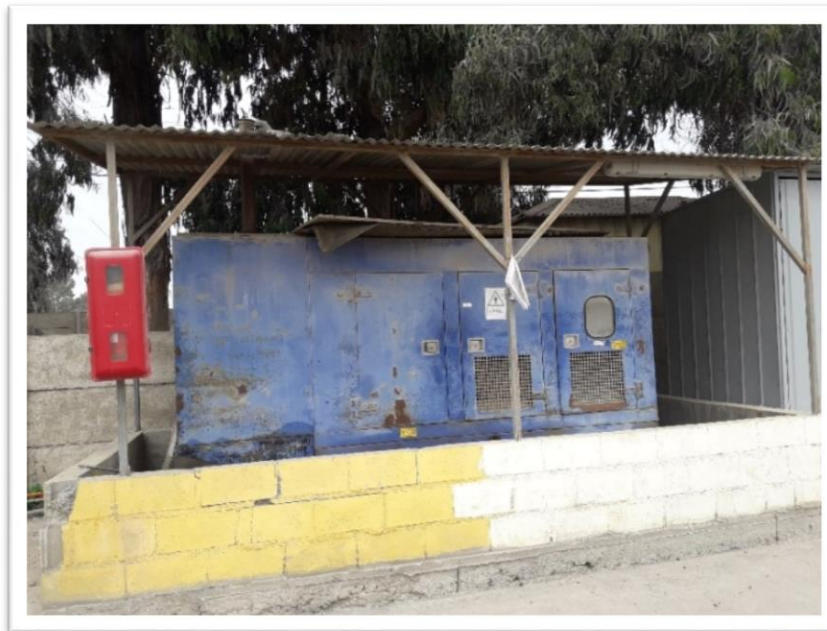
Imagen 3-17; Generador eléctrico, Cummins.
