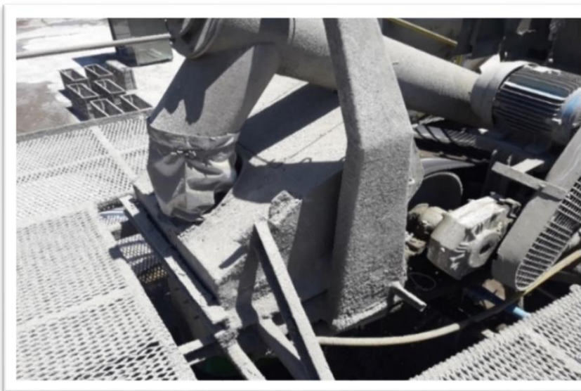
Imagen B-14; Tolva unificadora de descarga.
