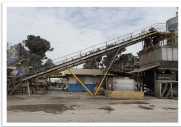
Imagen B-6; Estructura cinta de carga áridos.
