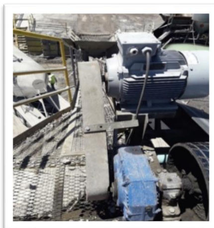
Imagen B-10; Motor eléctrico (lado superior), reductor (lado inferior).
