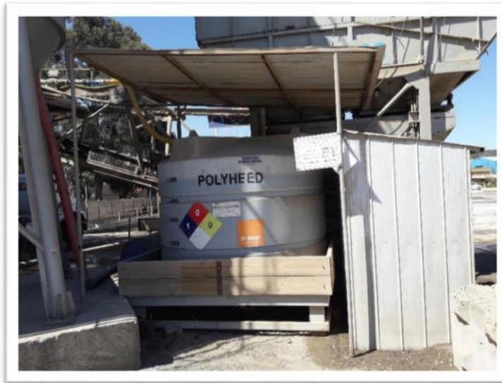
Imagen 3-10. Estanque Aditivo Base.
