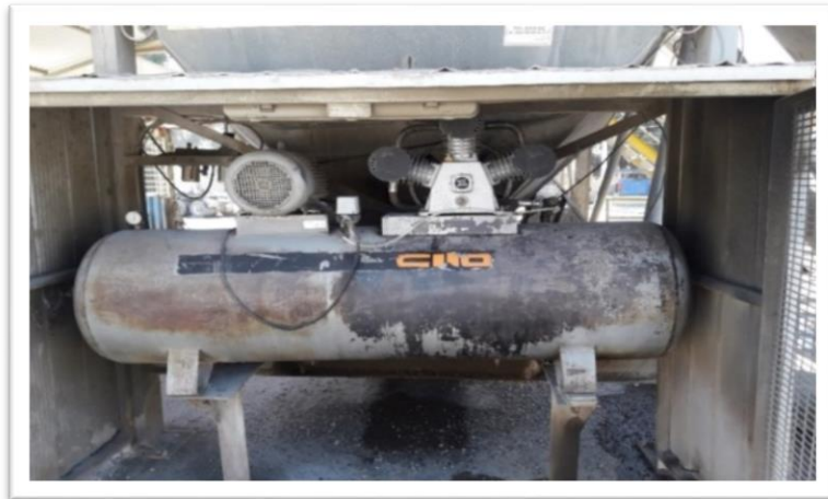
Imagen 3-2; Compresor de aire.
