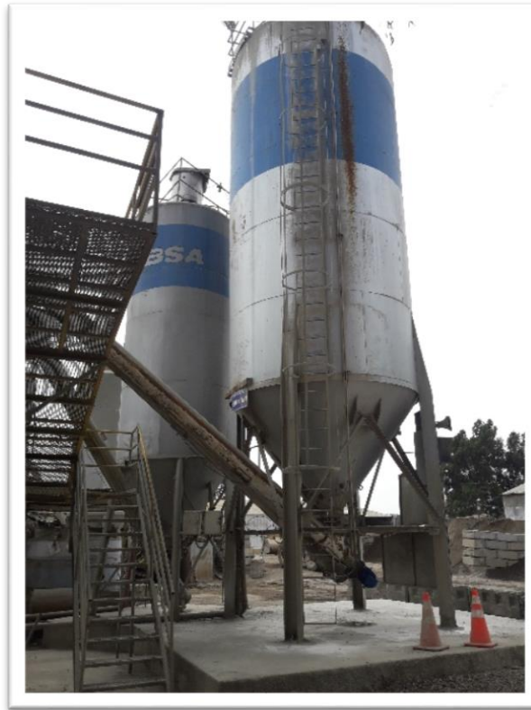
Imagen 3-11. Silo de cemento.
