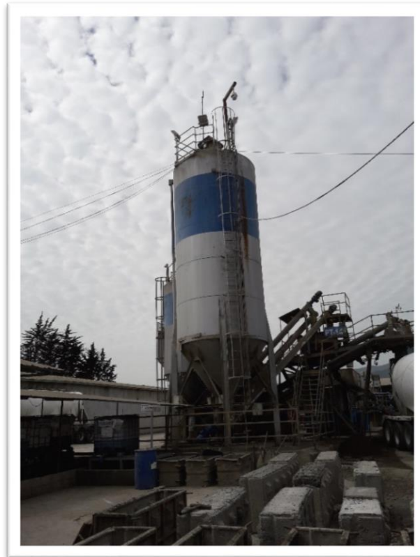
Imagen B-20; Componentes adicionales silo de cemento.
