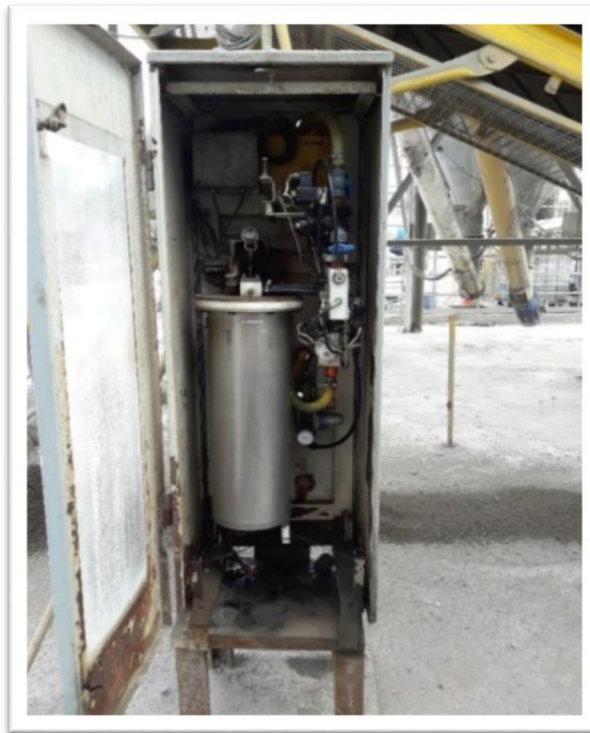
Imagen 3-7; Vaso dosificador de aditivo.
