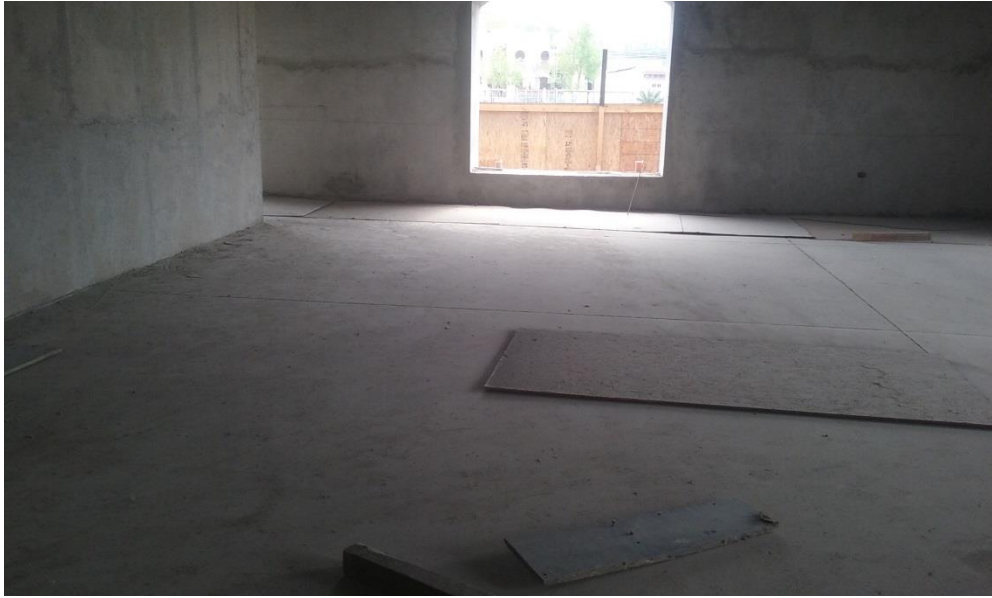
Figura: 2-8. Sector Patio de maniobras Norte
