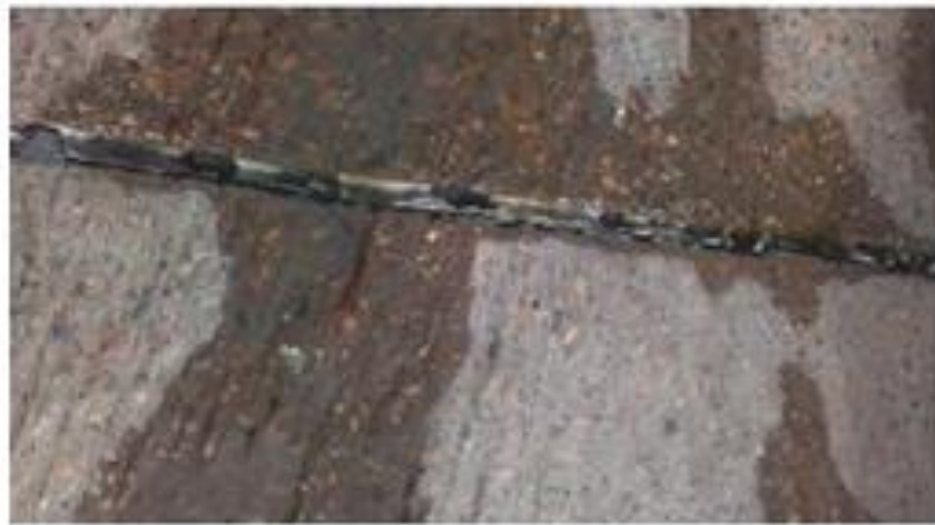
Figura 7-1: Erosión Paralela al Flujo de Relaves en Fondo Canaleta
