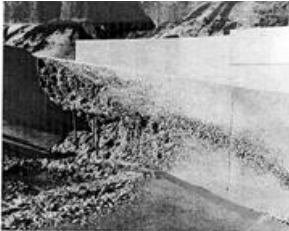
Figura 2-7: Daño por Cavitación en Cámara de Descarga (ACI 210-R93)
