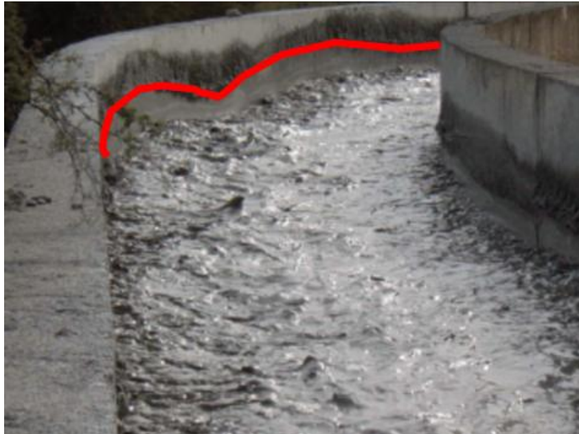
Figura 3-13: Revancha insuficiente en Curvas
