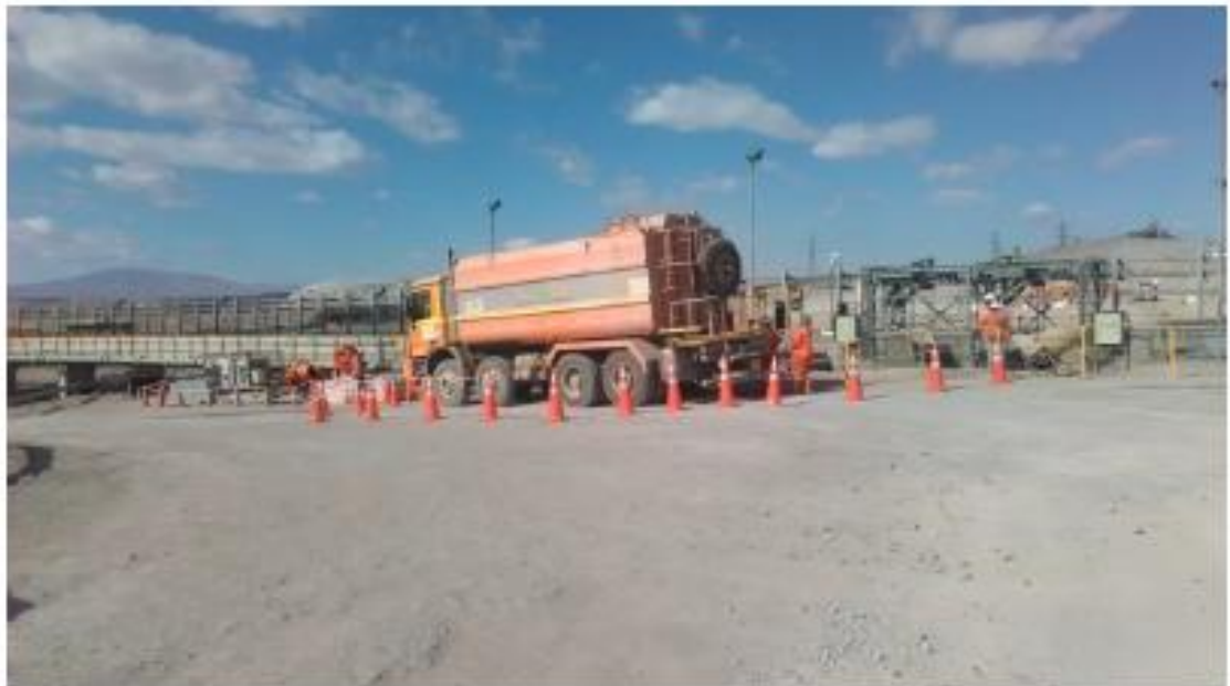
Figura 7-4: Suministro de Agua mediante Camión Aljibe
