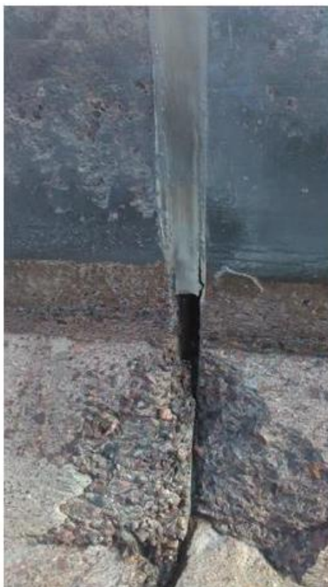
Figura 7-2: Erosión en Junta de Construcción
