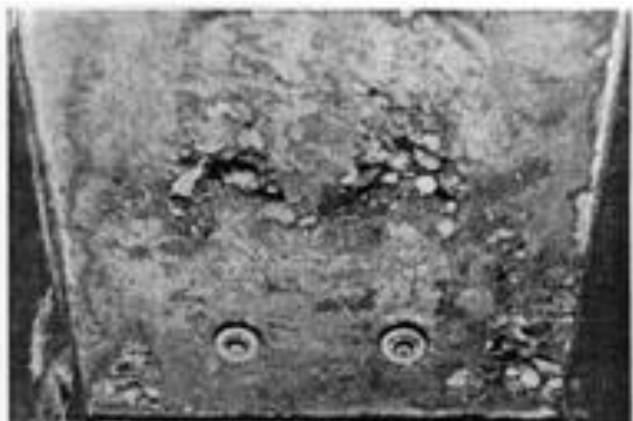
Figura 2-6: Prueba de Cavitación Generada por Irregularidades (ACI 210-R93)
