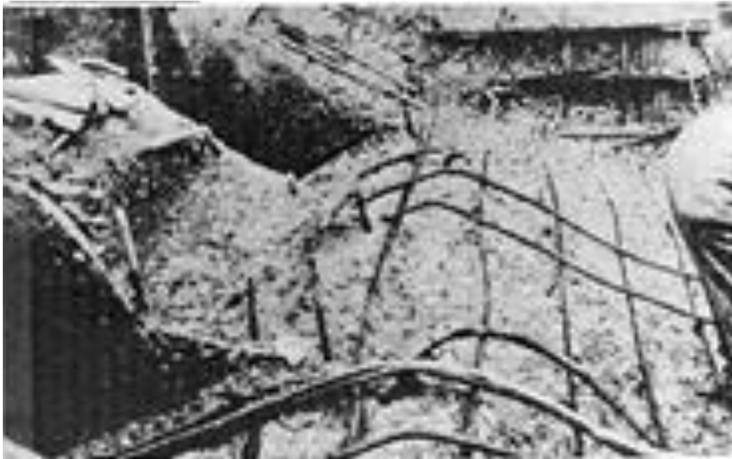
Figura 2-8: Daño por Cavitación Aguas Abajo de Irregularidades (ACI 210-R93)
