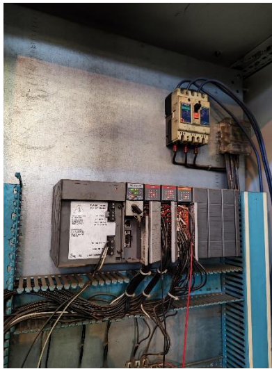
Figura 3-1: PLC actual del equipo.
