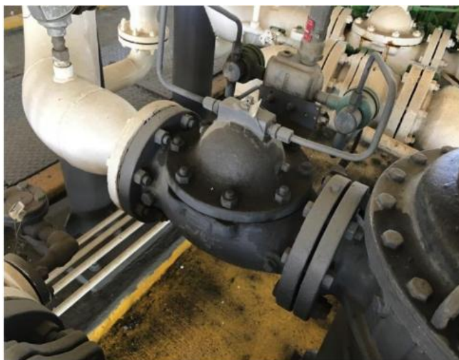
Figura 11. Válvula de control electrohidráulica modelo 210 utilizada en líneas de despacho [27]. Fuente: Elaboración propia (fotografía tomada en terreno).
