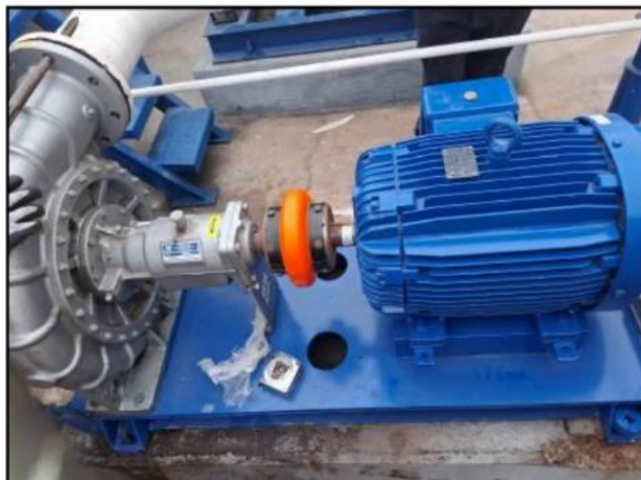
Figura 9 Motobomba de proceso para combustible gasolina, acople omega y motor intrínseco. Fuente: Elaboración propia (fotografía tomada en terreno).
