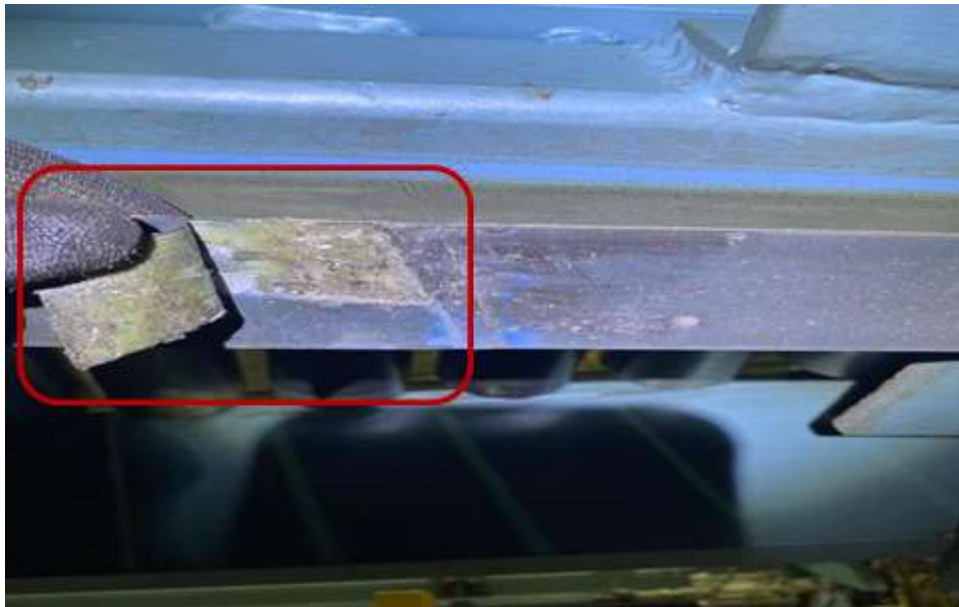
Imagen N° 11: desgarro de empalme
