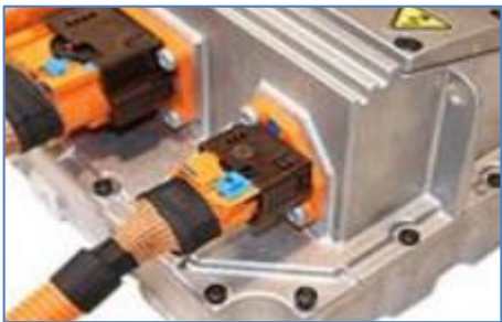
Ilustración 4-2. Cableado de corriente máx. 30 [A].
