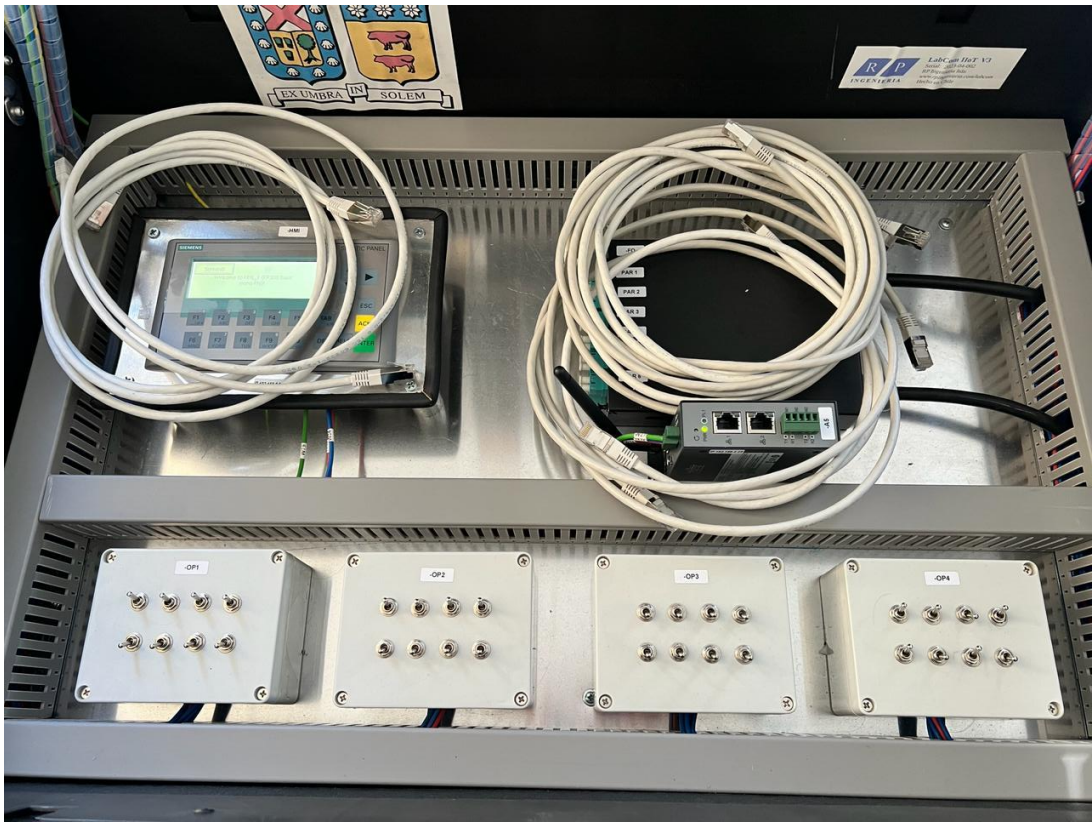
Figura 1-2. SWITCHES que activan las entradas de los equipos
