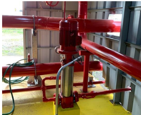
Figura 10: Bomba Jockey en SCI Copec Fuente: elab. propia
