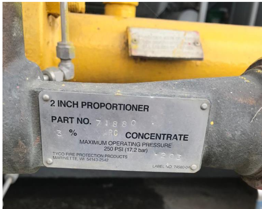
Figura 157: Dosificador en sistema de espuma, Copec Fuente: Elab. propia
