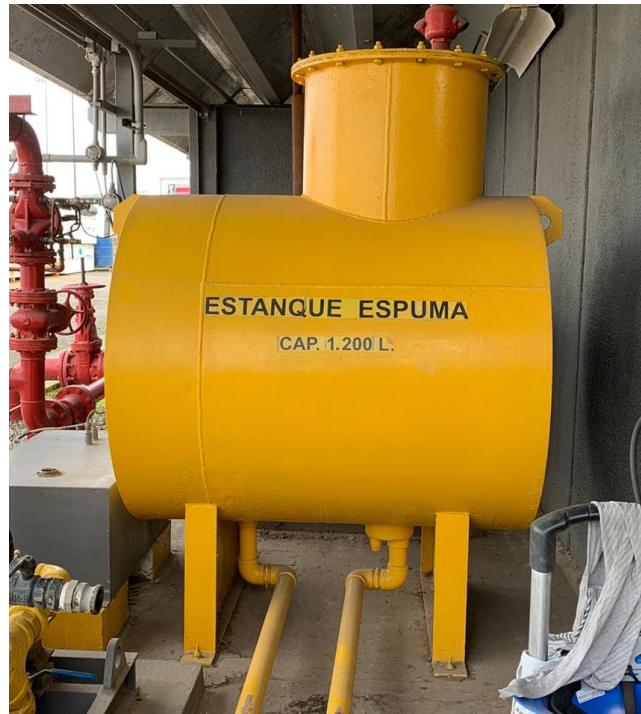
Figura 146: Estanque de almacenamiento de espuma en planta Copec
