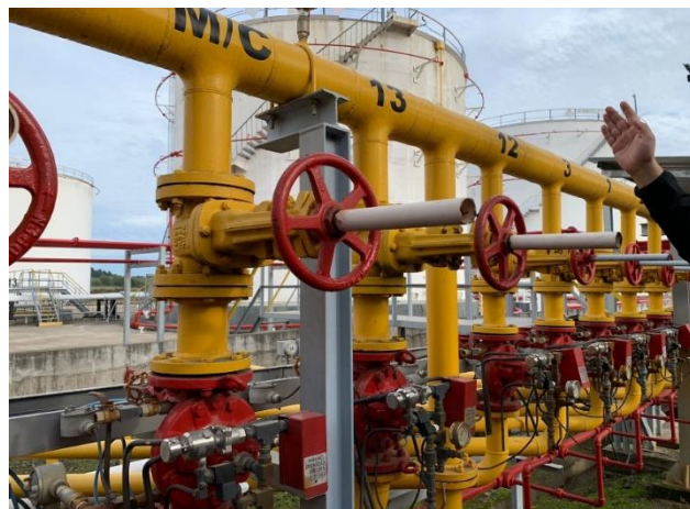
Figura 204: Manifolds para suministro de espuma, Copec Fuente: Elab. propia
