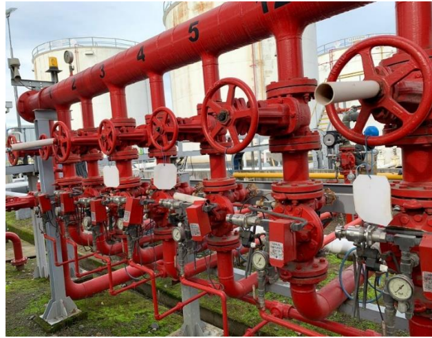
Figura 193: Manifolds para suministro de agua, Copec Fuente: Elab. propia
