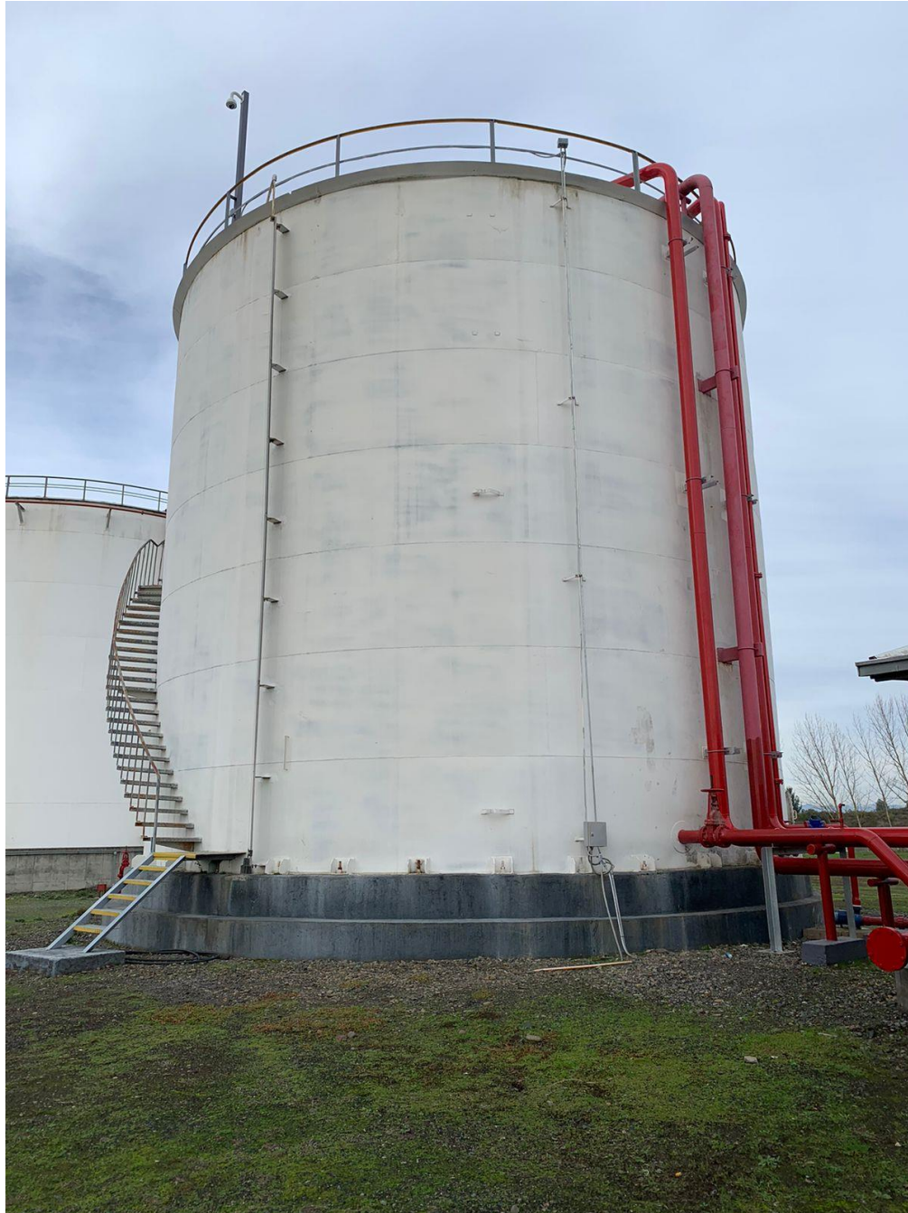
Figura 1513: Estanque de agua, Copec
