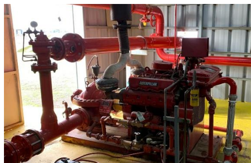
Figura 102: Bomba centrífuga y motor CI
