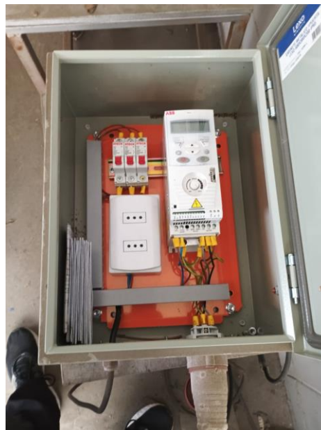
Figura 19: Tablero electro molino de barras.
