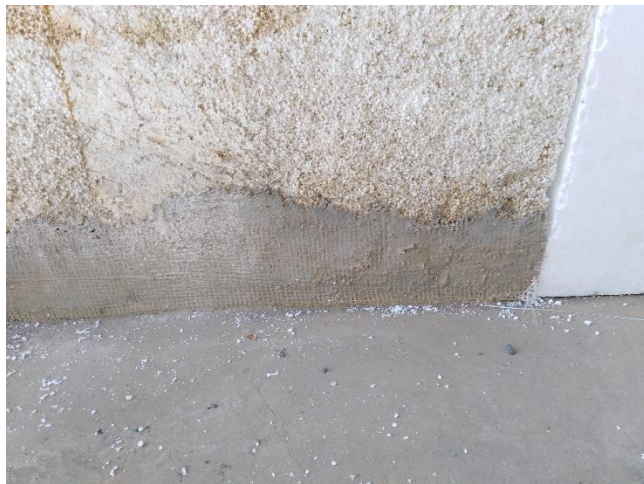
Imagen N°13: Encapsulamiento en borde inferior
