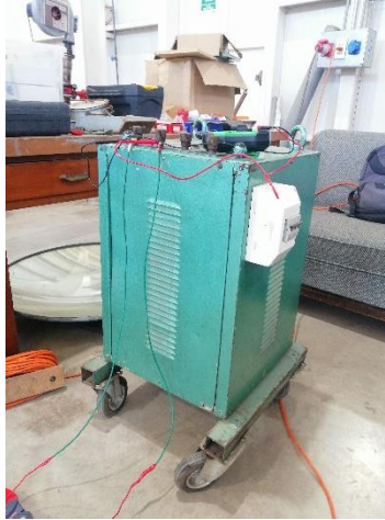
Figura 4.12: Variador de voltaje. Fuente: Elaboración propia.
