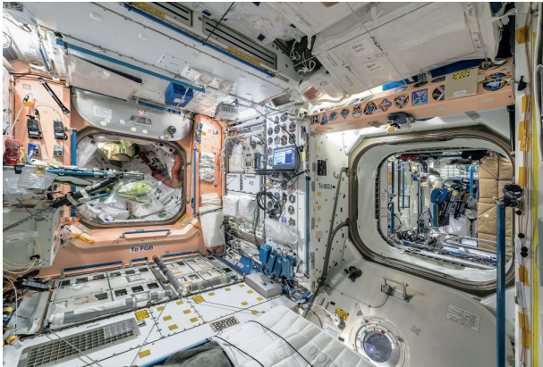
Interior Nodo 1 Unity, se muestra la conexión entre 2 módulos. Fuente nasa.gov
