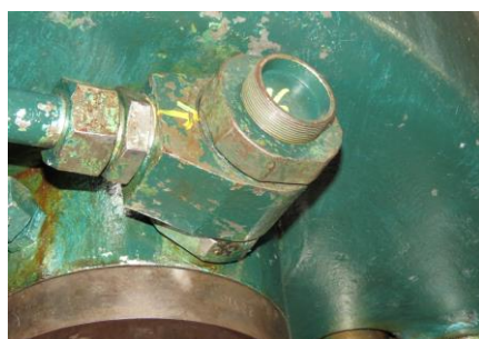
Figura 29- Conector oleohidráulico reparado.
