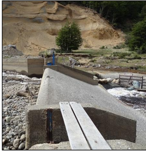
Figura 7.2: Estado de la Captación Las Minas – Visita a terreno 26/11/15
