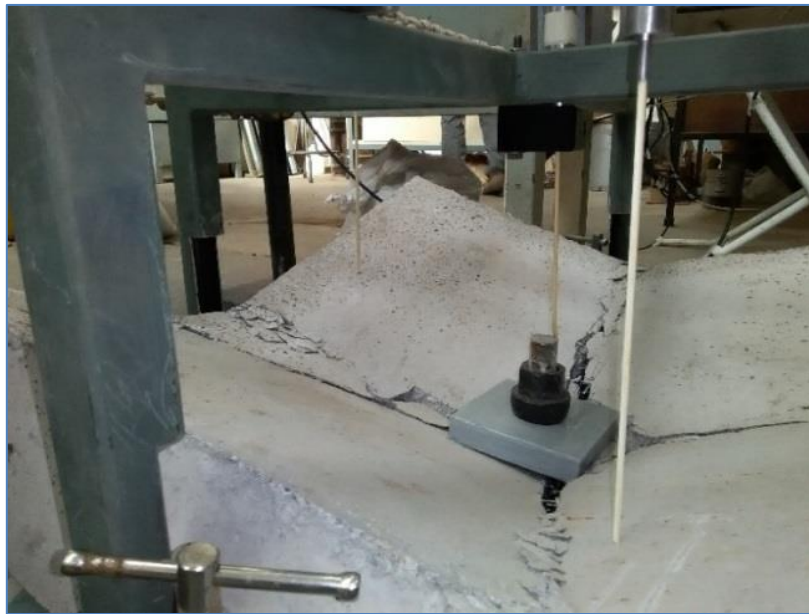
Imagen 21: Panel con claros signos de punzonamiento en su superficie debido a la tracción del perno de anclaje
