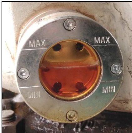
Figura 3-2. Visor de nivel equipo P1502-B utilizando aceite Mobil SHC 624. Fuente: Levantamiento fotográfico de planta HDT, Enap Biobío.
