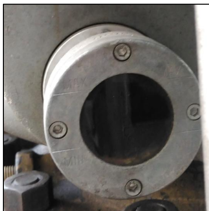
Figura 3-3. Visor de nivel equipo P1502-A utilizando aceite Royal Purple. Fuente: Levantamiento fotográfico de planta HDT, Enap Biobío.
