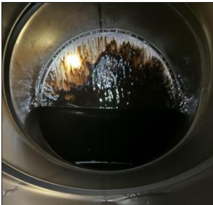
Figura 2-17. Tambor de Royal Purple ISO 32 con sedimentos. Fuente: Levantamiento fotográfico bodega de lubricación, Enap Biobío.
