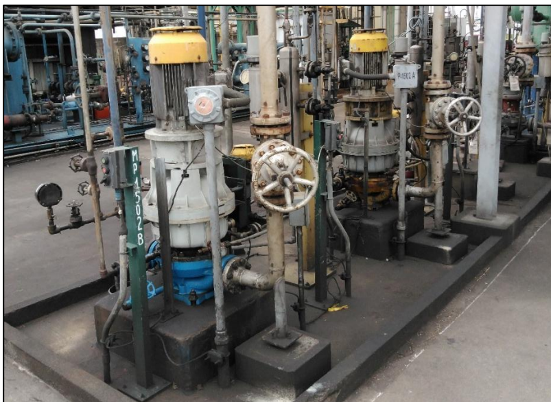
Figura 2-6. Bomba P1502-B (Izquierda) y P1502-A (Derecha). Fuente: Levantamiento fotográfico de planta HDT, Enap Biobío.
