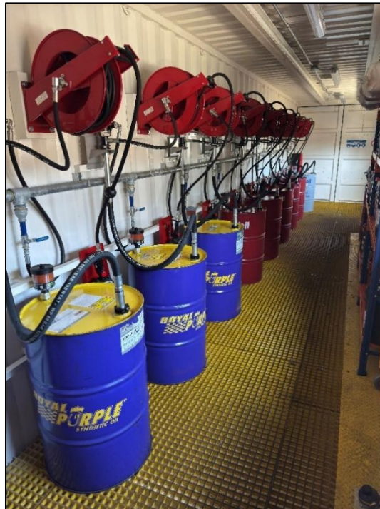
Figura 2-16. Almacenamiento de tambores de aceite. Fuente: Levantamiento fotográfico bodega de lubricación, Enap Biobío.
