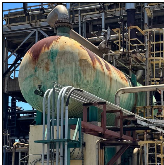
Figura 2-5. Acumulador D1505. Fuente: Levantamiento fotográfico de planta HDT, Enap Biobío.
