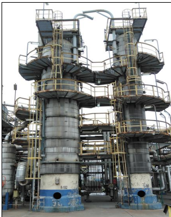
Figura 2-4. Reactor R1502 (izquierda) y reactor R1501 (derecha). Fuente: Levantamiento fotográfico de planta HDT, Enap Biobío.
