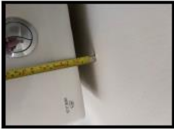
Distancia muro estanque mayo a 2 cm
