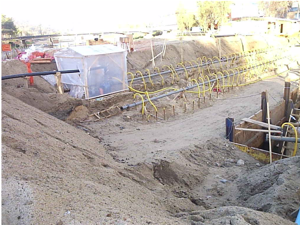
Figura N° 4.8 Sistema de punteras conectada a bomba de vacío.
