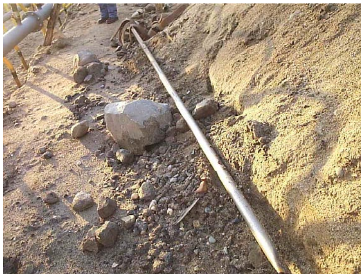
Figura N° 8.1 Tubería de acero para inyección de agua a alta presión
