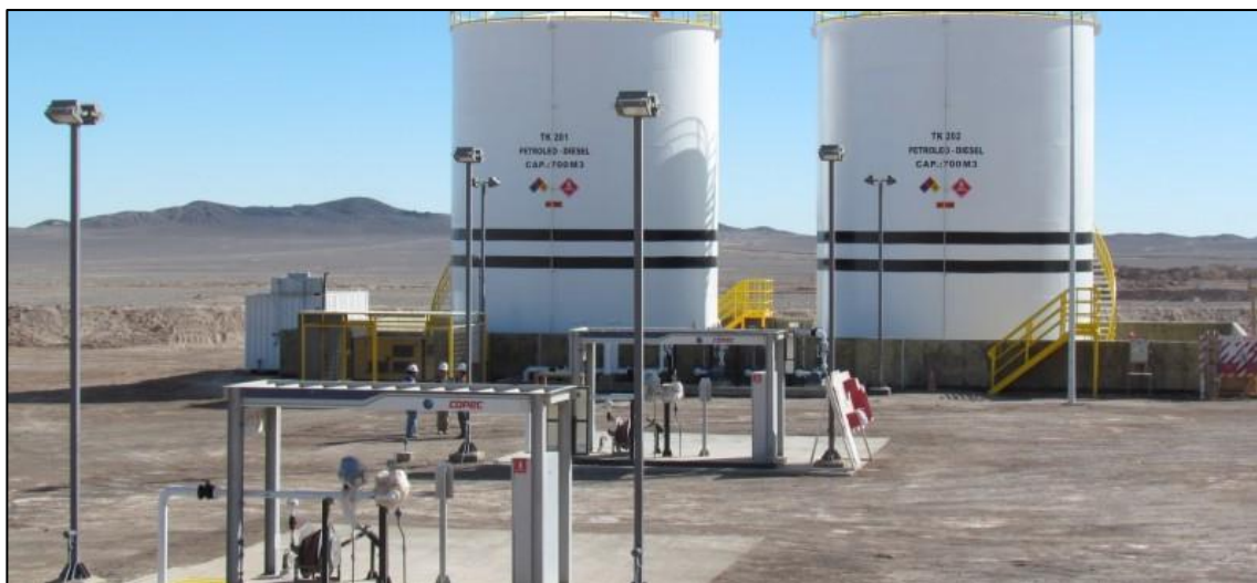
Fig. 8 Planta de combustible fija en rajo minero
