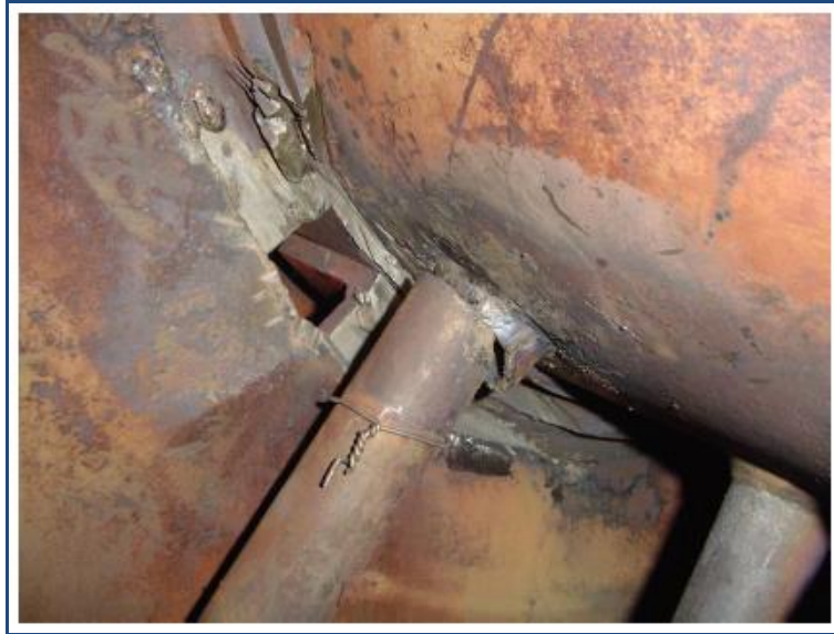
Figura 6.7 Rotura en cabezal de vapor producto de fatiga térmica. Fuente: Flexibility conference Chile, Engie lab.
