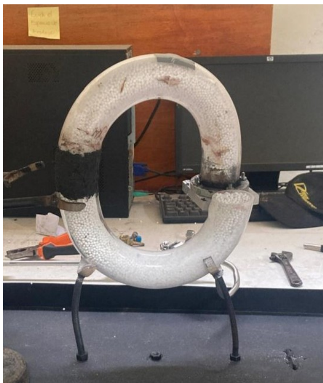
Figura 7.1: Quemador tipo O Fase 2 instalado
