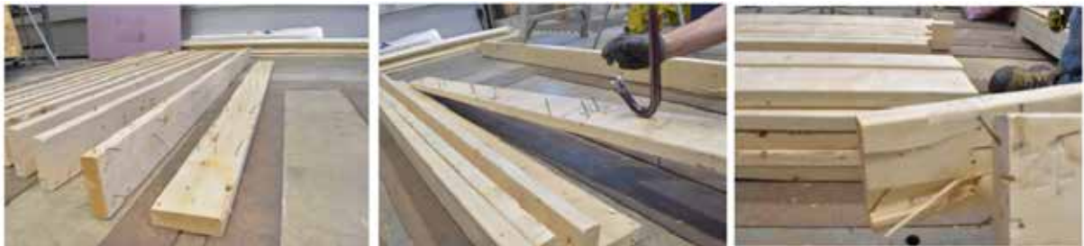
Figura 05. Fotografías de los montantes removidos, con claros daños visibles. Fuente: Torres et al. (2025).
