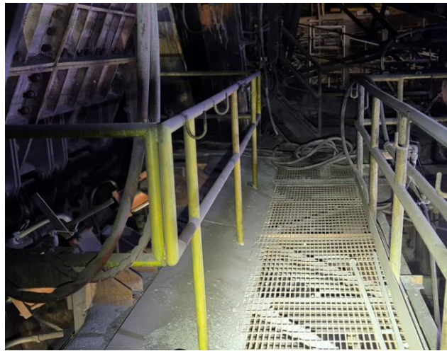
Figura 18 Acumulación de polvo en estructuras a ser limpiadas.
