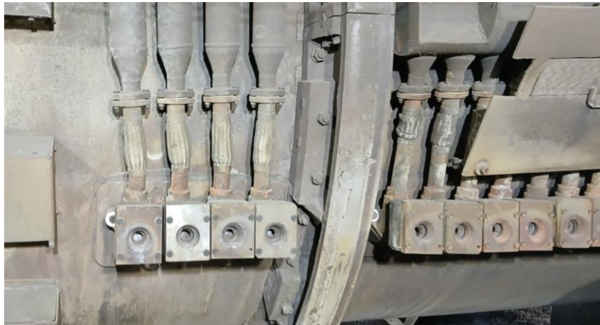
Figura 38 Opción de utilización de flexibles con uniones mediante bridas utilizada en otra fundición de Chile.
