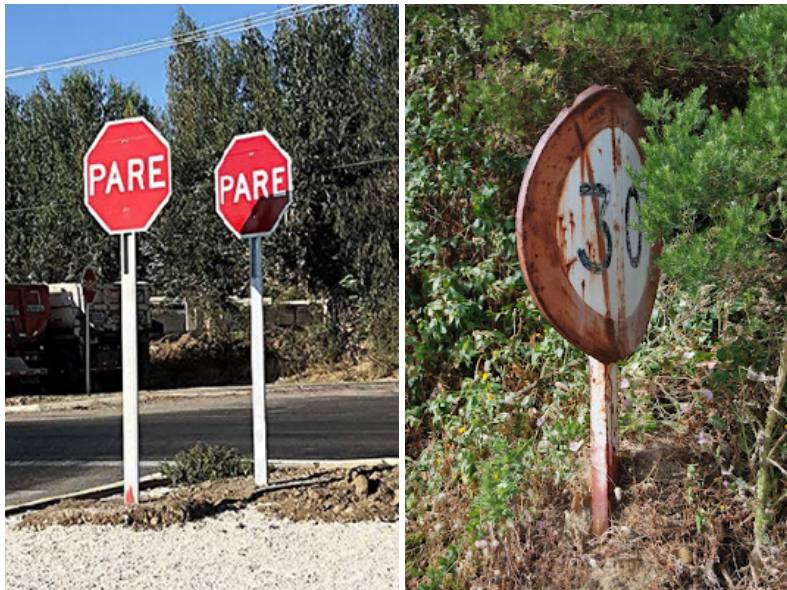
(a) Pare en mal estado por duplicidad de señalización (b) Señalización Velocidad Máxima dañada por acción ambiental.
