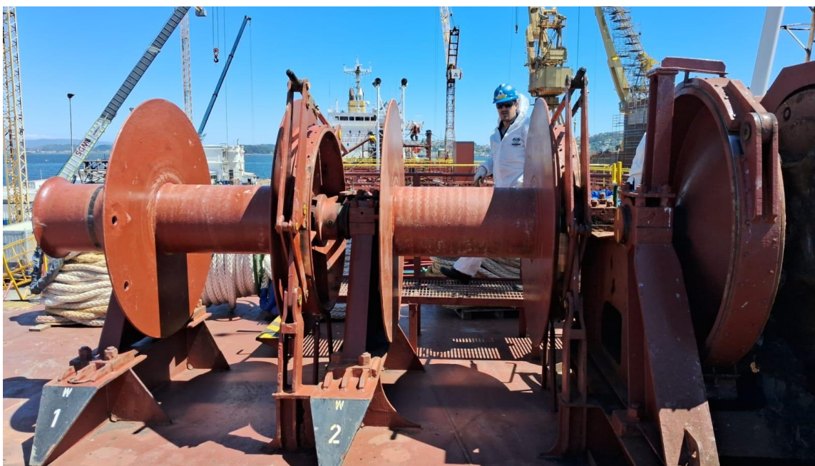
Ilustración 2-11.- Cabrestante Hidráulico de anclaje
