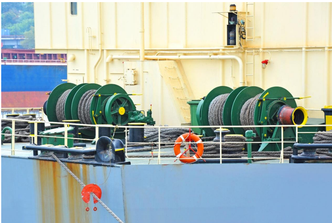
Ilustración 2-1.- Cabrestante Hidráulico de anclaje
