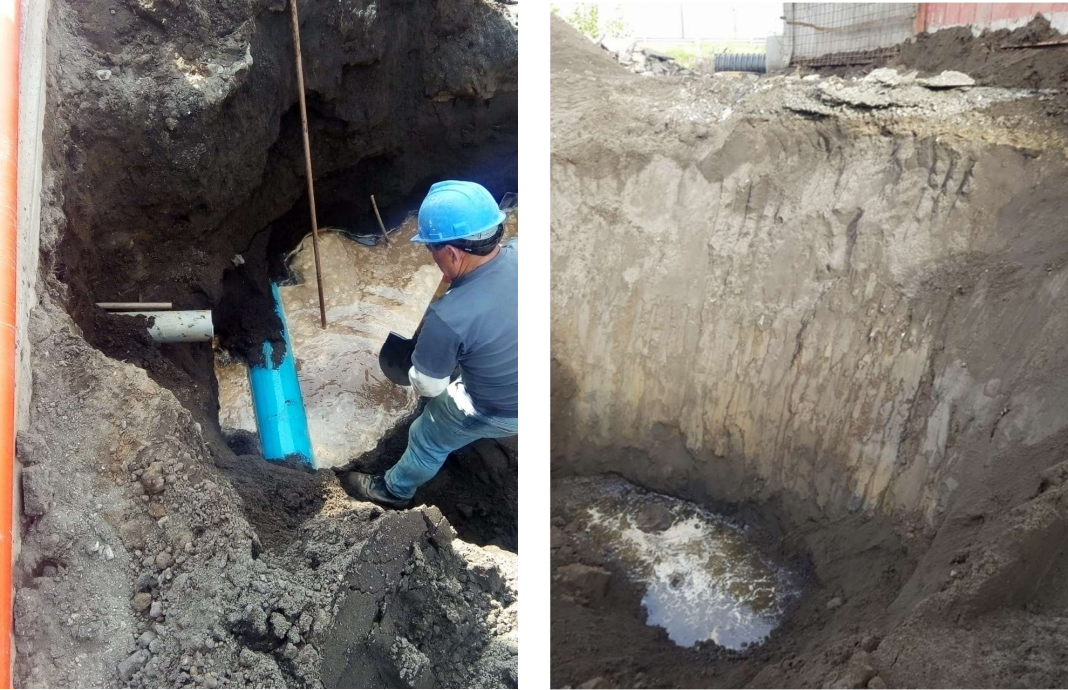
Figura 17 Derrumbes de terreno e inundaciones en obra
