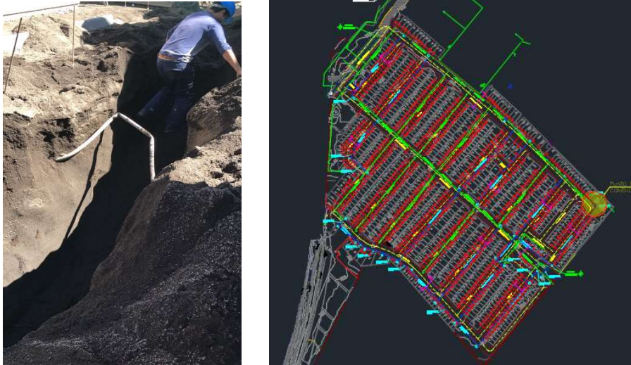
Figura 9 Daño en cañerías
