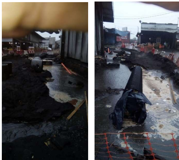
Figura 12 Inundaciones en las zonas de trabajo por falta de vías de evacuación de aguas lluvia
