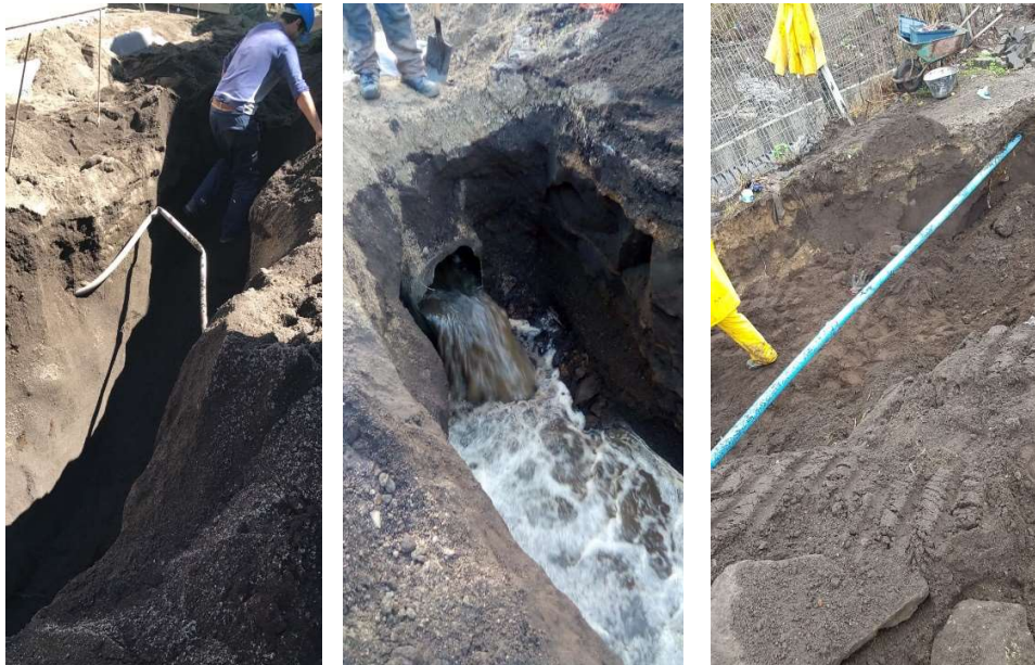
Figura 14 Rupturas de cañerías de agua potable
