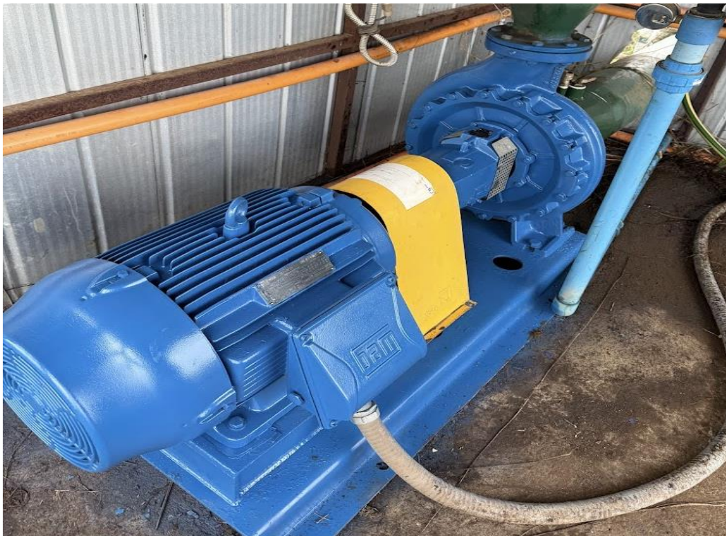
FIGURA 2 – 6. Conjunto bomba centrífuga horizontal acoplada a motor eléctrico trifásico.
