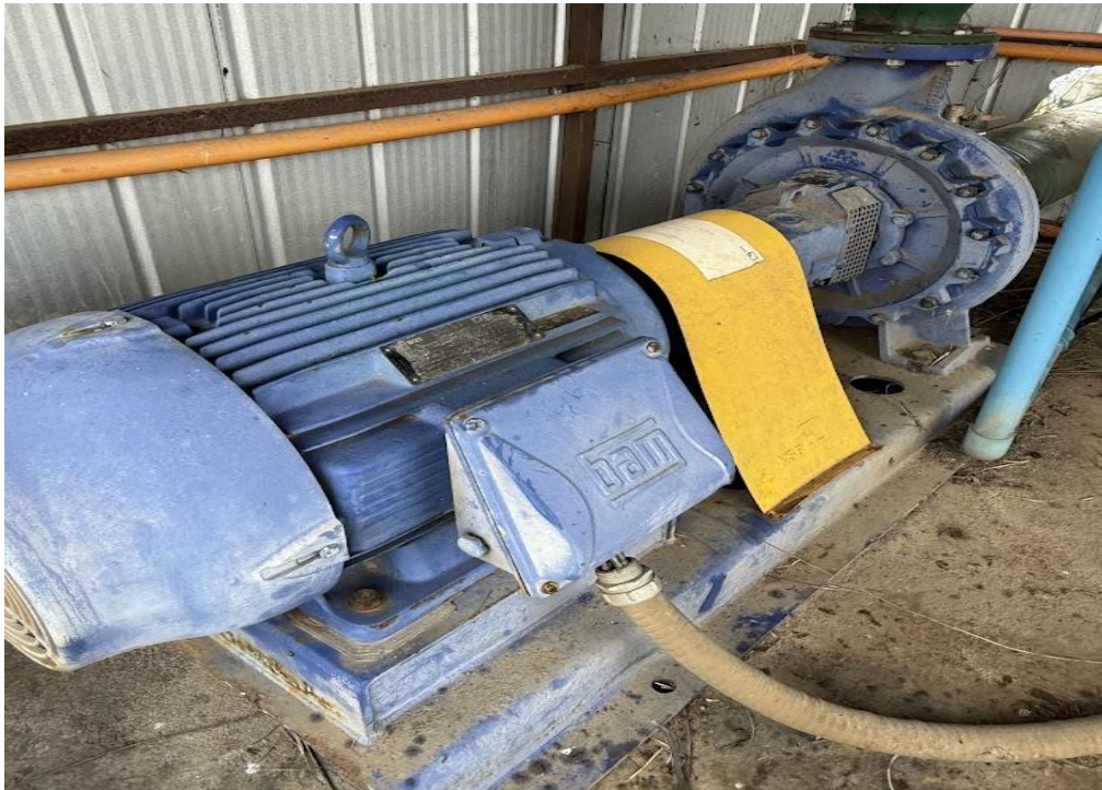
FIGURA 3-1 Sistema de bombeo del cliente agrícola Transvaal SPA
