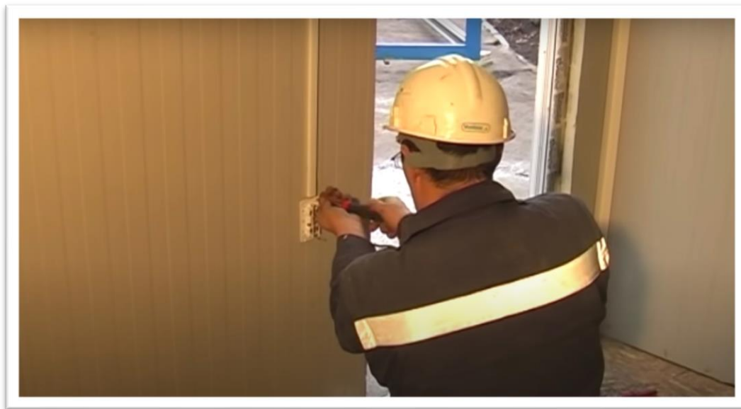
Fuente: https://www.youtube.com/watch?v=oH4fU0awKlg Figura 2-5.- Instalación eléctrica.
