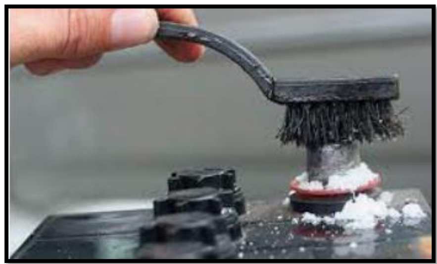
Figura 3-15. Limpieza de una batería solar Fuente: damiasolar.com
