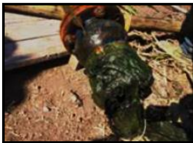
Figura 3-10. Válvula de pie obstruida Fuente: sag.cl
