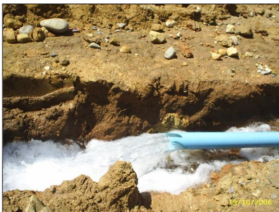
FOTO 28 – Rotura matriz exist. Calle 3 PMB Pobl. Argentina Alto – Quilpué – Octubre 2006
