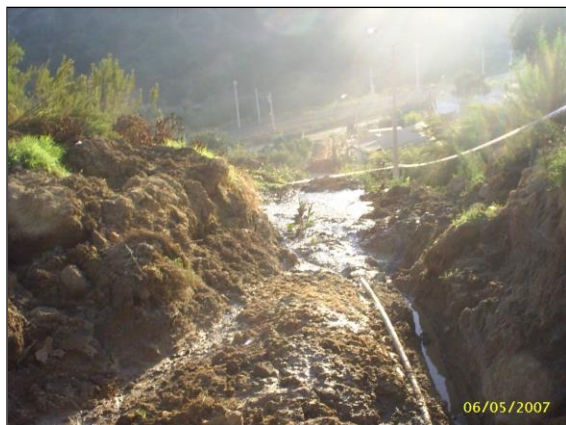
FOTO 32 – Desplazamiento Barro existente Calle 14 – Pobl. Argentina Alto – Quilpué – Mayo 2007
