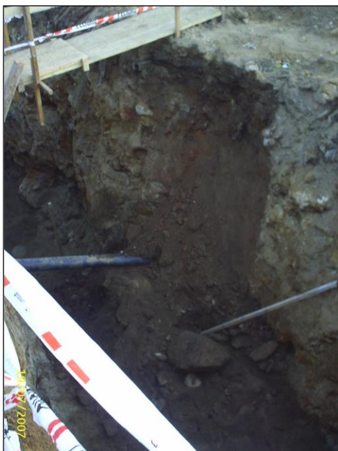
FOTO 36 – Derrumbe pared excavación Alcantarillado Calle 5 - Pobl. Argentina Alto – Quilpué – Julio 2007
