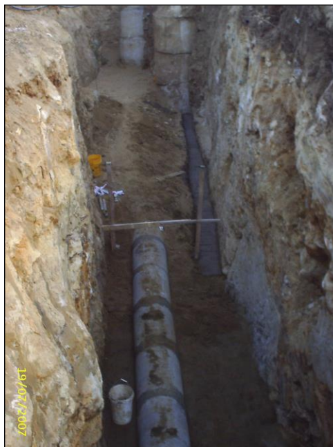
FOTO 35 – Redes de A.L.L. y Alcantarillado Calle 5 - Pobl. Argentina Alto – Quilpué – Julio 2007
