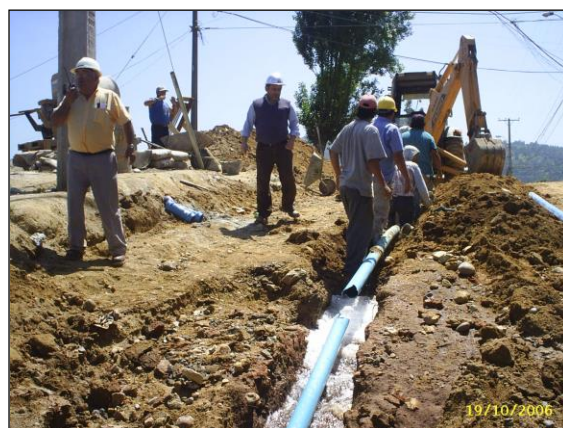
FOTO 27 – Rotura matriz exist. Calle 3 PMB Pobl. Argentina Alto – Quilpué – Octubre 2006
