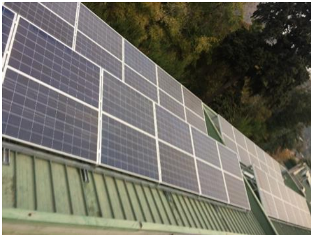
Figura 2 – 7. Circuitos de paneles fotovoltaicos.
