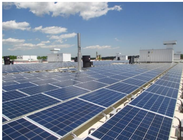
Imagen 7: Panel solar de 580 kilovatios en la azotea del edificio E-Motor de Operaciones Baltimore.
