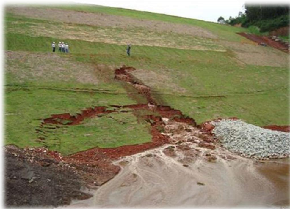
Figura 4-2: Efectos de la erosión interna en el talud aguas abajo del Dique 1 (Fundão Tailings Dam Review Panel, 2016).
