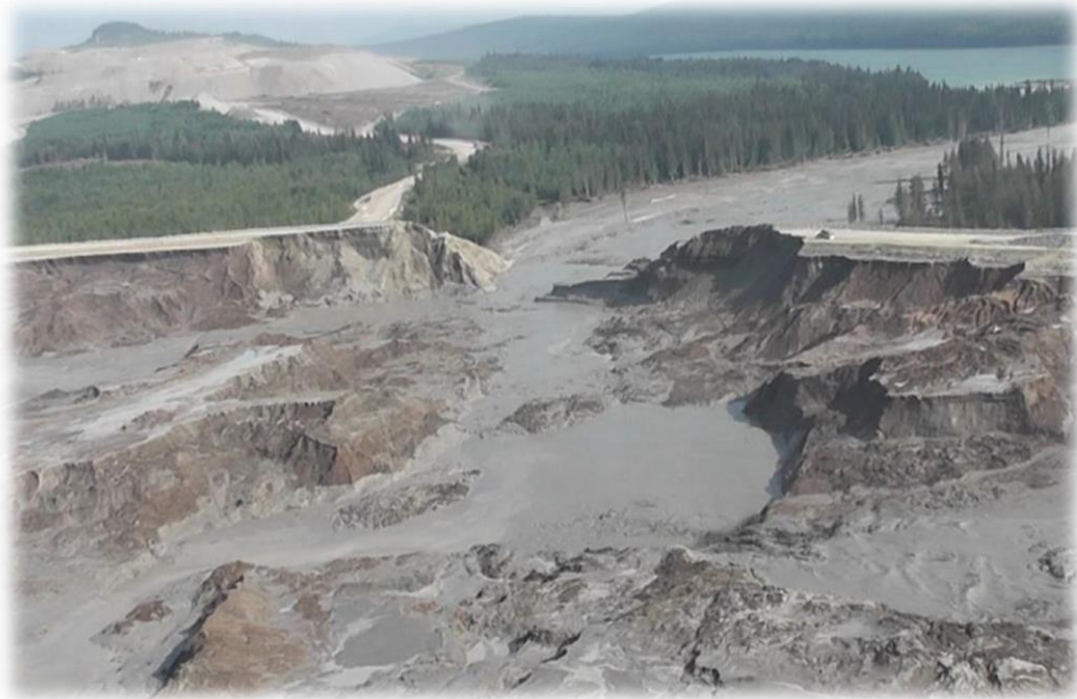
Figura 4-3: Colapso de muro de contención del Depósito de Relaves de la Mina Mount Polley (Mount Polley Review Panel, 2015).
