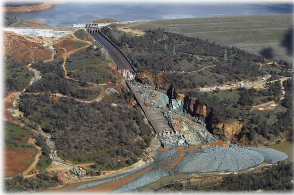
Figura 4-5: Daños ocasionados en el vertedero principal y de emergencia de la Presa Oroville, tras las importantes precipitaciones (El País, 2017).
