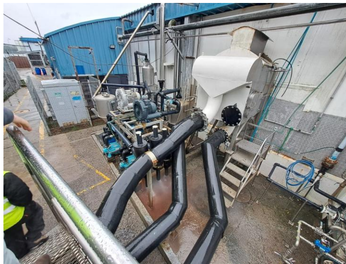
Ilustración 1: Bombas de vacío MOWI Caicaén
