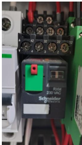
Ilustración 3: Relé de control en tablero existente
