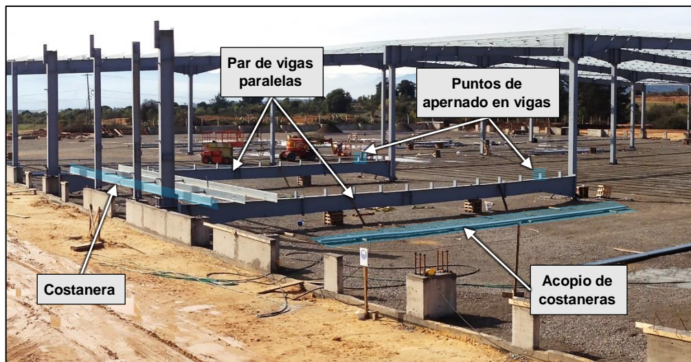
Figura 5.5. Zona de trabajo típica para montaje de costaneras. Montaje de costaneras a nivel de suelo
