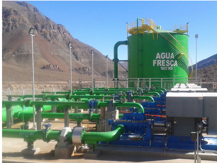
Figura 6.4: Estación de impulsión N°2
