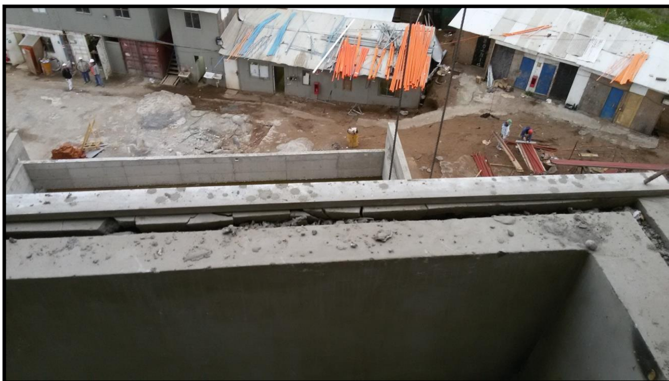
Fuente: Registro Obra Alto Lilenes Figura 2-17.Terraza quebrajada
