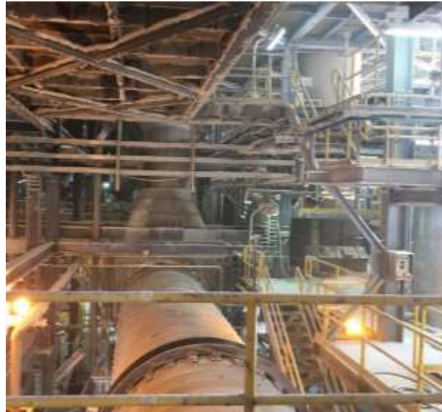
Figura 23. Vista zona descarga secador S-9202_03B
