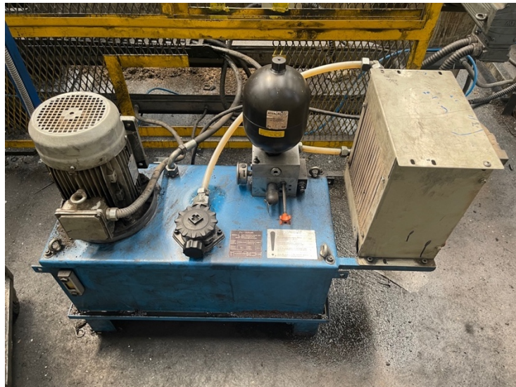
Ilustración 14 - Central hidráulica Perfiladora.
