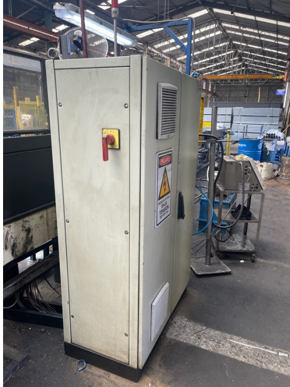
Ilustración 12 - Tablero de control Perfiladora.
