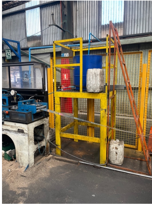
Ilustración 15 - Sistema de refrigeración Perfiladora.
