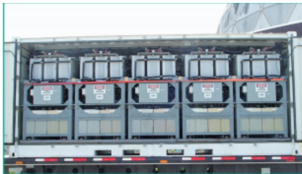
Figura 3.18: Sistema de baterías de flujo de 500kW. Fuente [26]
