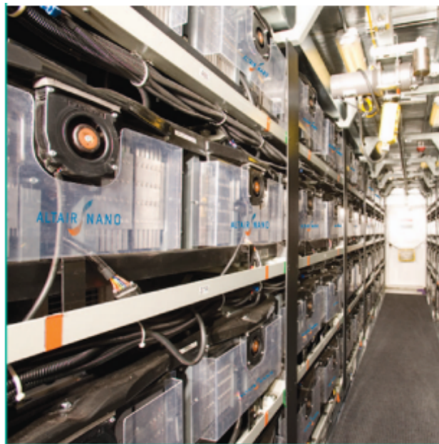
Figura 3.19: Sistema de baterías Litio-Titanio de 1000 kW. Fuente [26]
