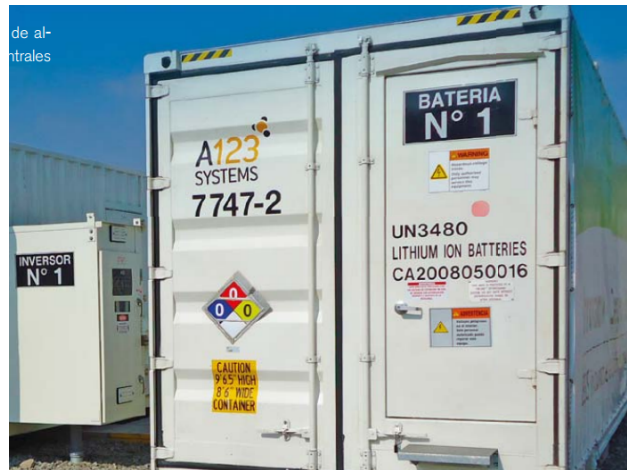
Figura 5.15: Módulo de batería de litio de 2MW. Fuente [52]
