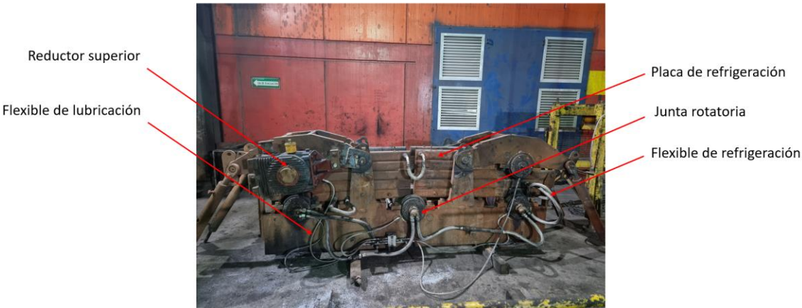
Figura 5-5. Extractora de palanquillas de colada continua CAP acero Fuente: Elaboración propia
