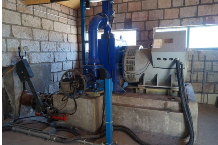
Figura 4.20: Turbina Pelton y generador síncrono que conforman la unidad hidroeléctrica actual de Socaire.
