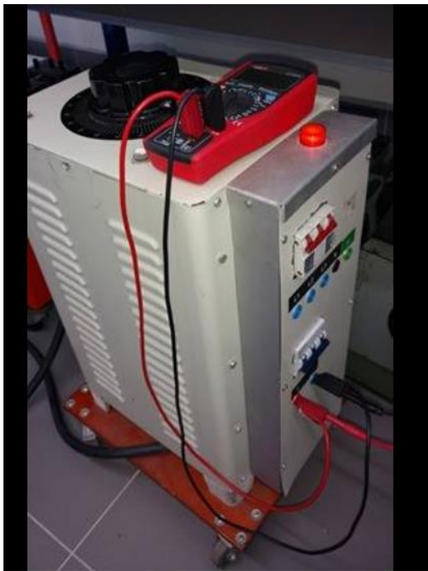
Figura 80 Transformador de alimentación DC del circuito.
