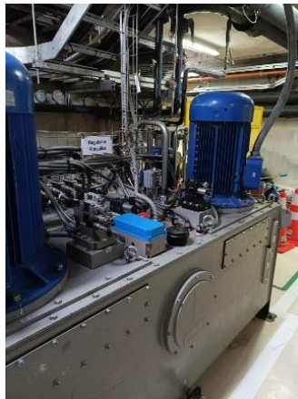
Ilustración 2. Gobernador o Unidad Oleo-Hidráulica (imagen propia).
