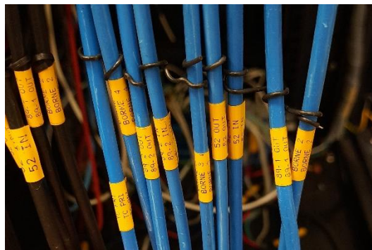
Figura 3.35: Disposición y rotulación real del cableado del circuito primario en el rack.
