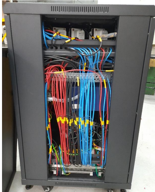
Figura 3.41: Vista lateral del paño eléctrico a escala.
