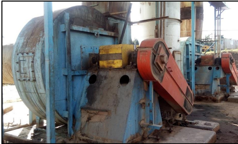
Figura 4- 21: Fotografía muestra corrosión en VTI centro
