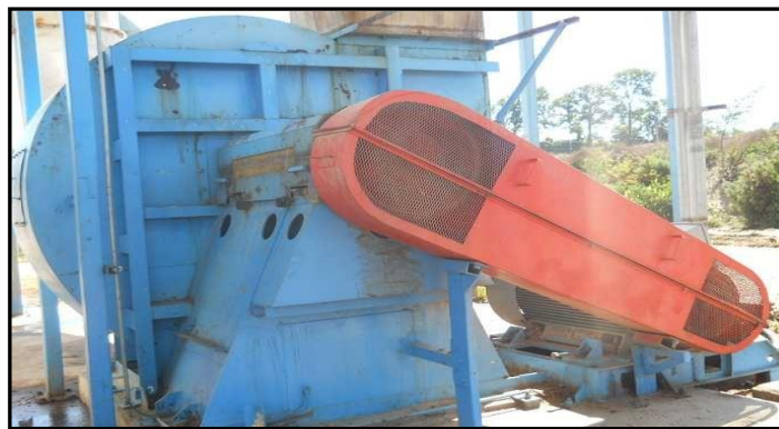
Figura 4- 1: Ventilador de tiro inducido de secado de centro
