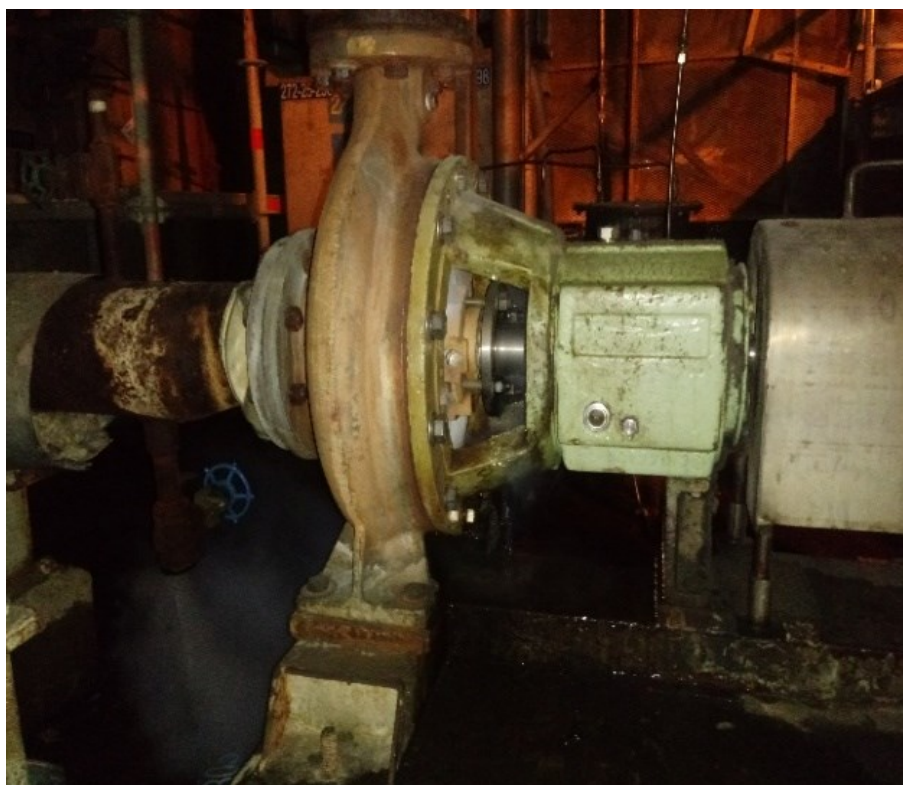
Figura 2- 2: Bomba centrífuga sulzer app3, 272-21-306.
