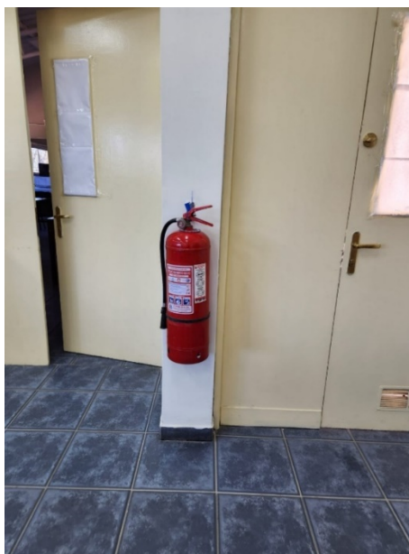
Imagen 4- 9 Extintor del laboratorio Fuente. Imágenes tomadas en el laboratorio
