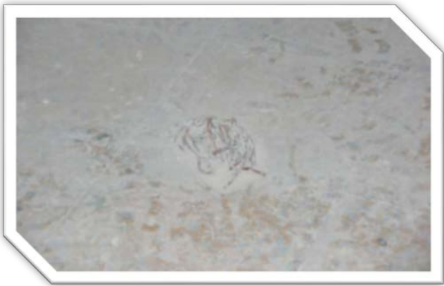
Figura 4-7. Toma de tierra cortada
