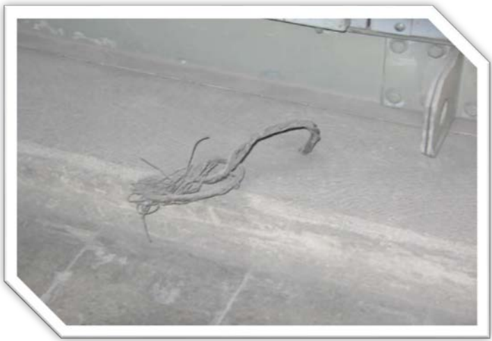
Figura 4-6. Toma de tierra cortada y desconectada
