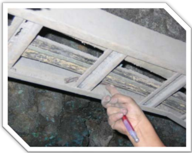
Figura 4-5. Cable de interconexión del sistema de tierra cortado
