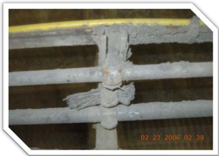
Figura 4-4. Inexistencia de cable de tierra
